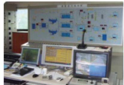
〈Water Plant control〉
