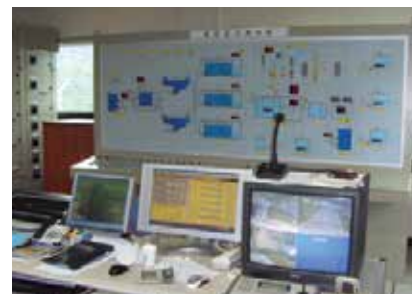
<Estação de tratamento de água automatizada controlada remotamente>
