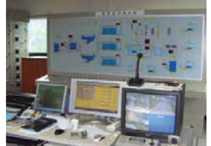
<Uzaktan kontrol edilen otomatik su arıtma tesisi>
