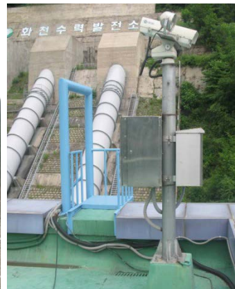
S/S Roof CCTV
